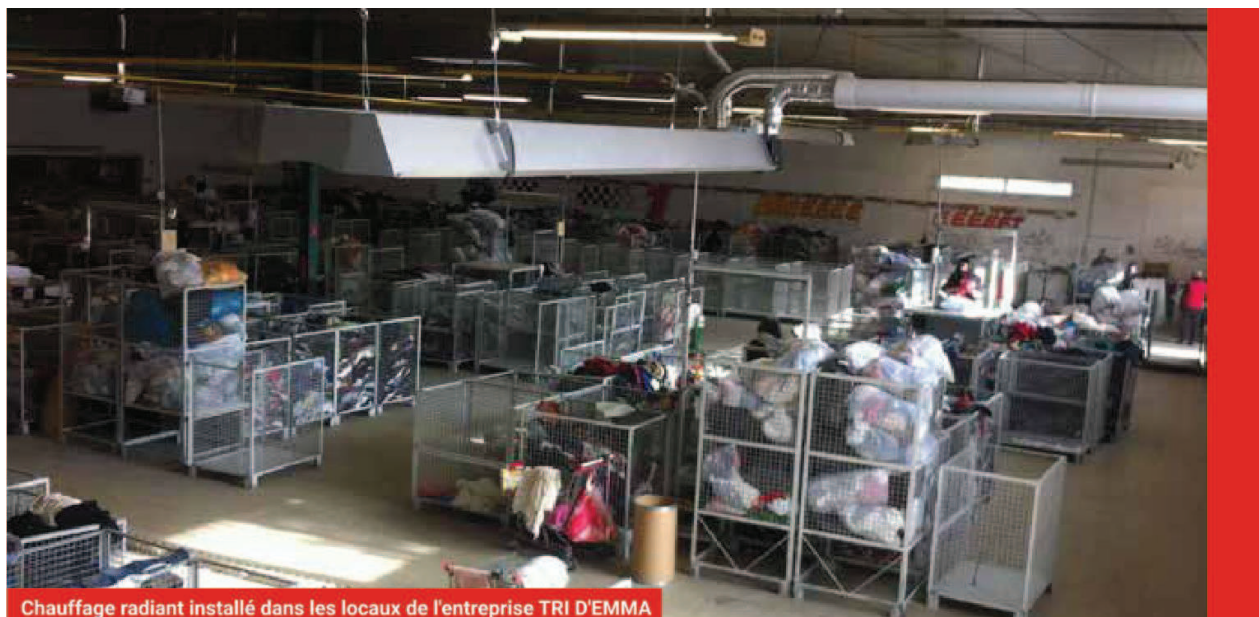
Chauffage radiant installé dans les locaux de l'entreprise TRI D'EMMA
